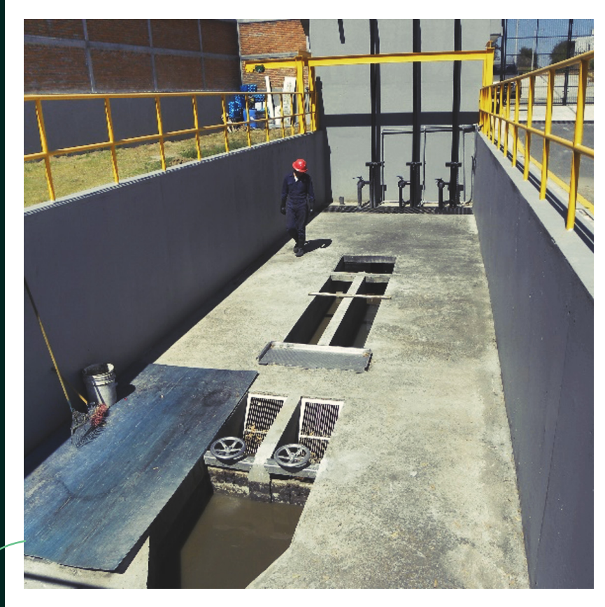
FIGURA 5.3 TRATAMIENTO PRELIMINAR CON REJILLAS Y DESARENADORES PARA AGUAS RESIDUALES MUNICIPALES (FUENTE: IBTECH).
