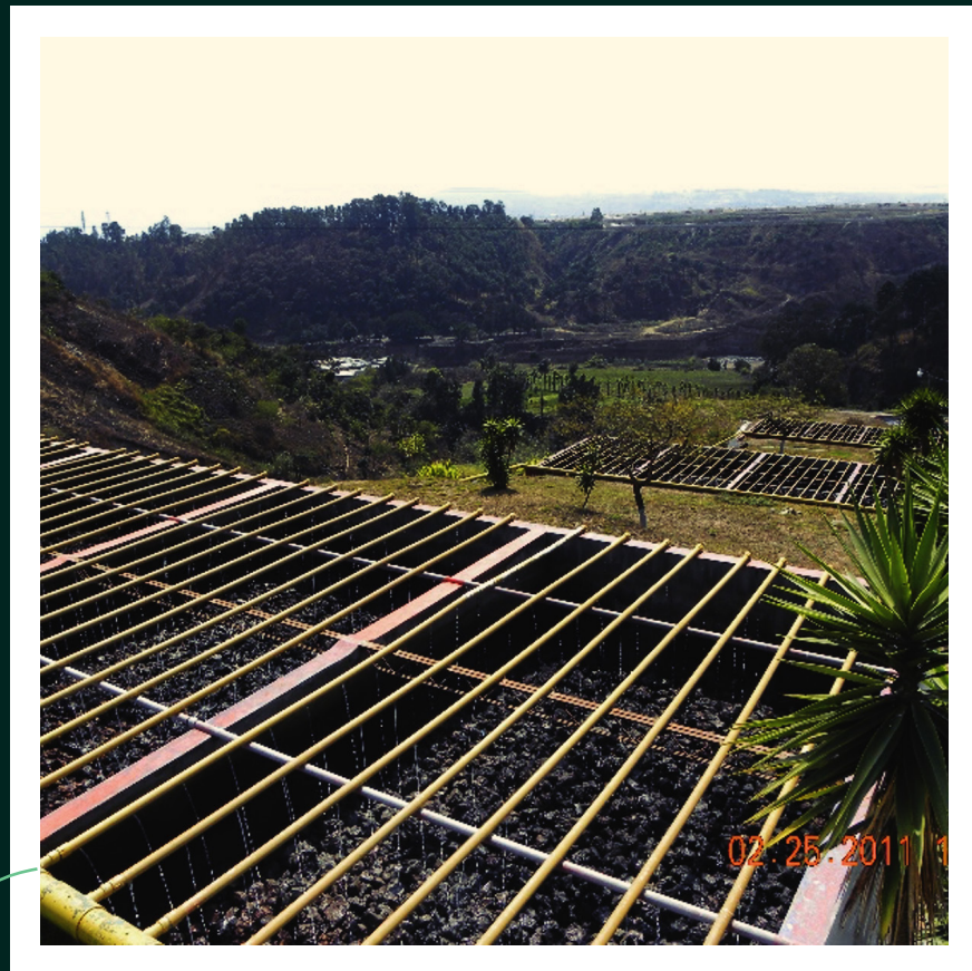
FIGURA 5.6 FILTROS PERCOLADORES DE BAJA TASA PUESTOS EN SERIE PARA EL TRATAMIENTO DE AGUAS RESIDUALES MUNICIPALES (FUENTE: IBTECH)
