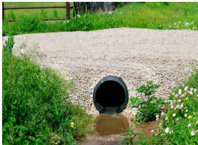
Imagen. Ejemplo alcantarillado en vialidad Fuente: Culvert Set Policy, 2022. https://mctxcompct1.org/culvert-set-policy/
